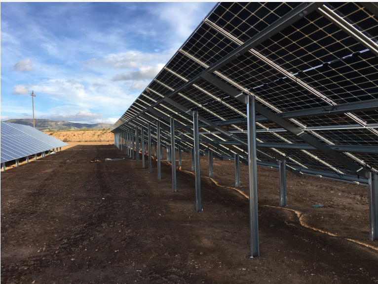
Estructura Doble Vertical biposte 2Vertical x 14módulos ,25°
